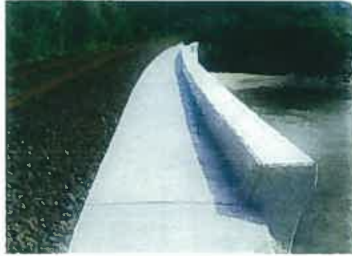
工事概要 海岸の擁壁に波返しを設置し、波による浸食から軌道設備の保護を行う。
