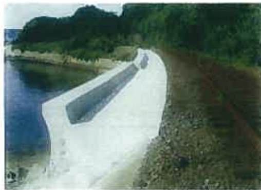
工事概要 海岸の擁壁に波返しを設置し、波による浸食から軌道設備の保護を行う。
